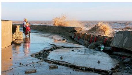
Đê kè Gành Hào, huyện Đông Hải (Bạc Liêu) bị sóng đánh gây sạt lở nghiêm trọng
